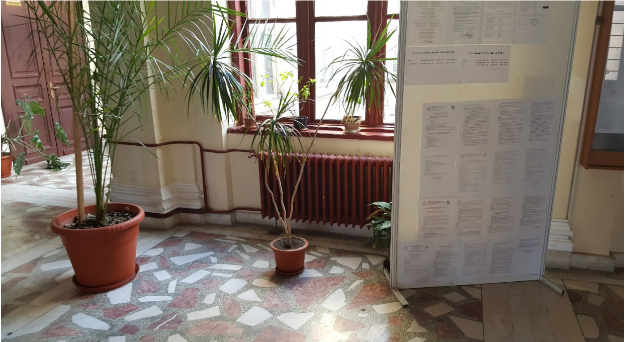
Foto1. Instalatii termice parter
