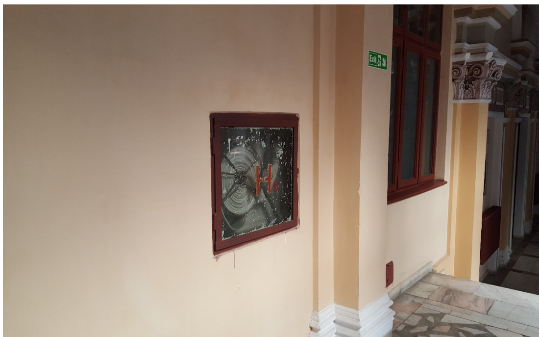
Foto17. Instalatie stingere la incendiu parter
