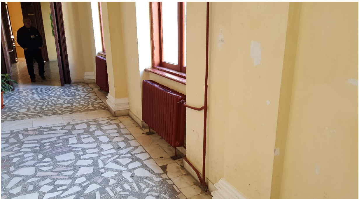
Foto2. Instalatii termice parter
