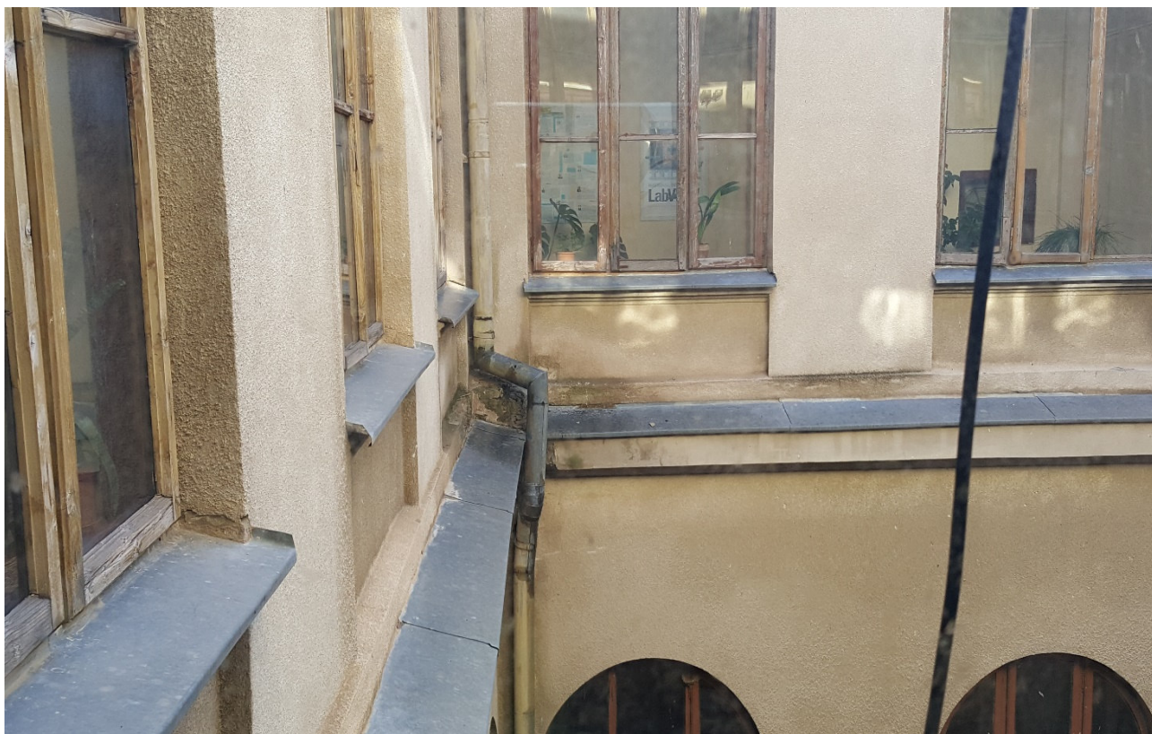
Foto12. Inslatatie ape pluviale etaj
