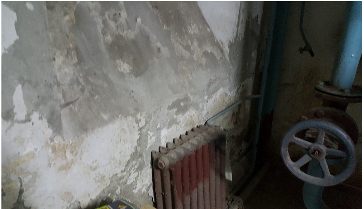
Foto 6. Instalatii termice mansarda
